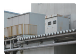
加高受电变压设施的设置场所，防止停电
